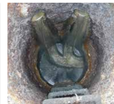
マンホール内の劣化状況
