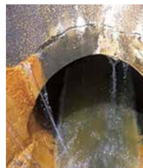
継ぎ目からの漏水
