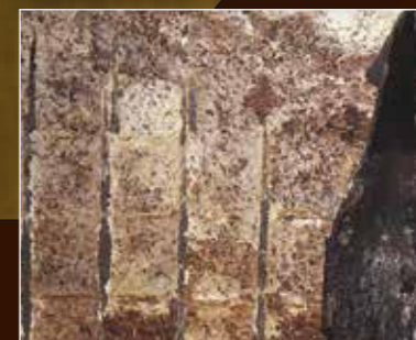
矩形マンホール特殊人孔の壁面の鉄筋露出・腐食状況
