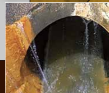
継ぎ目からの漏水
