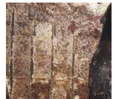
矩形マンホール特殊人孔の壁面の鉄筋露出・腐食状況
